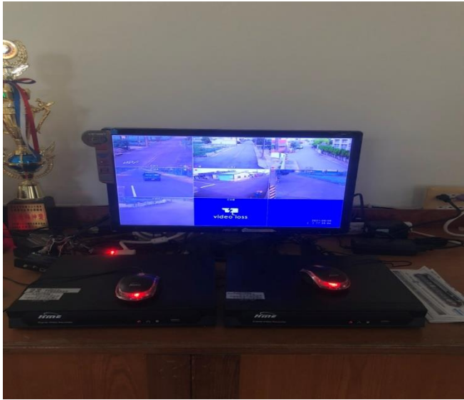
北埔社區監視系統監視主機更換維修計畫
