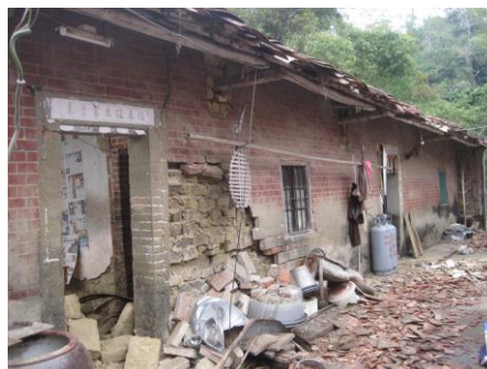
土崎 2 鄰考潭 14 號蔡福文受損情形
