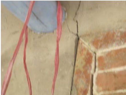
土崎 2 鄰考潭 14 號-蔡全寶(客廳龜裂)
