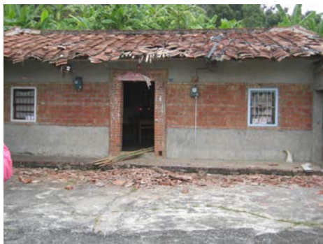
龍船里 1 鄰 10 號余榮本客廳屋瓦破裂 及右內臥室屋頂破裂
