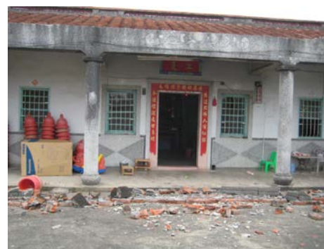
楠坑里 11 鄰草埔坪 21 號黃來春大廳屋 頂破裂、水塔損壞
