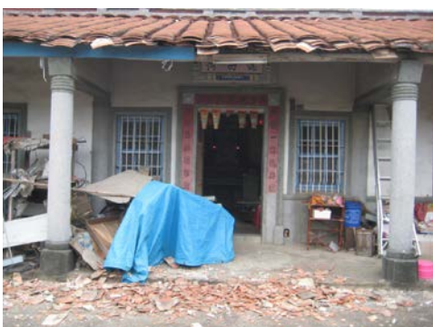
楠坑里 11 鄰草埔坪 23 號林奇和 大廳屋頂破裂、臥室牆壁損壞
