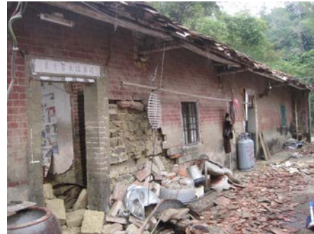
土崎 2 鄰考潭 14 號蔡福文受損情形
