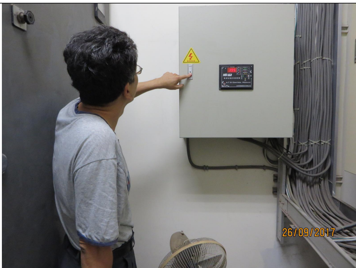
內容說明；安全防護班-關閉緊急發電機自動切換電源開關演練
