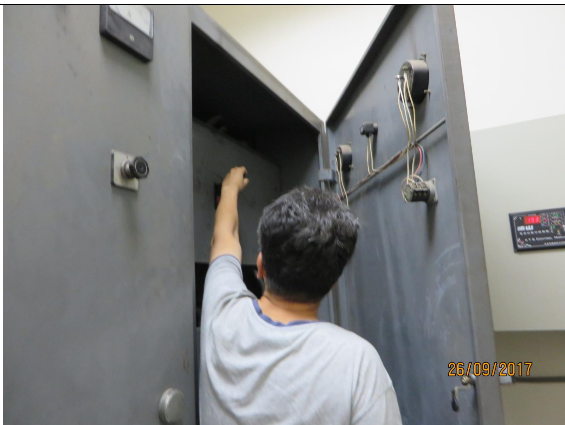
內容說明：安全防護班-關閉電源處置演練
